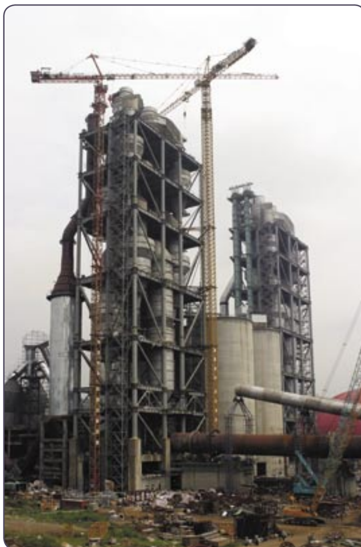
Forvarmer til F.L. Smidth's cementfabrik
